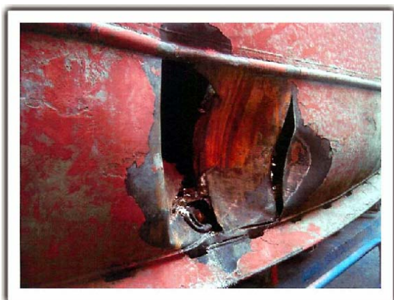
Figura 3. Daños bajo la flotación en el B/P PLAYA DAS DUNAS
