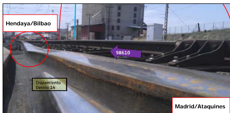
Vista del defecto de nivelación en altura en la zona anterior al punto "0".
