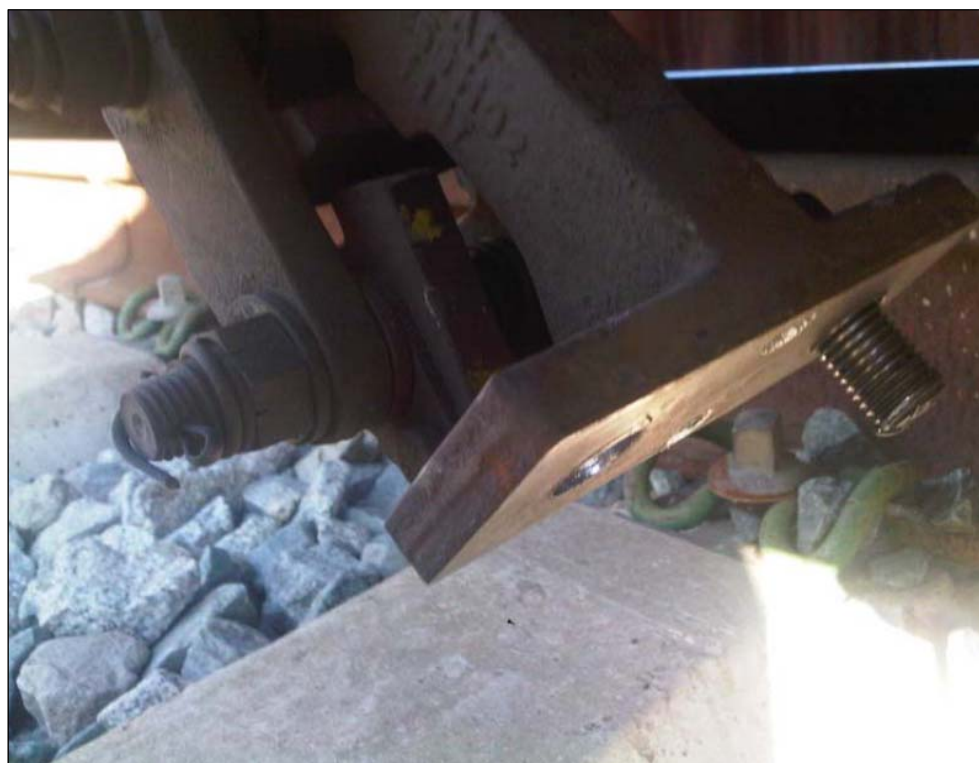
Pieza de sujeción del mecanismo de bloqueo de ancho de la rueda descarrilada. Falta un tornillo y el otro está aflojado. (Fuente: Renfe Operadora)
