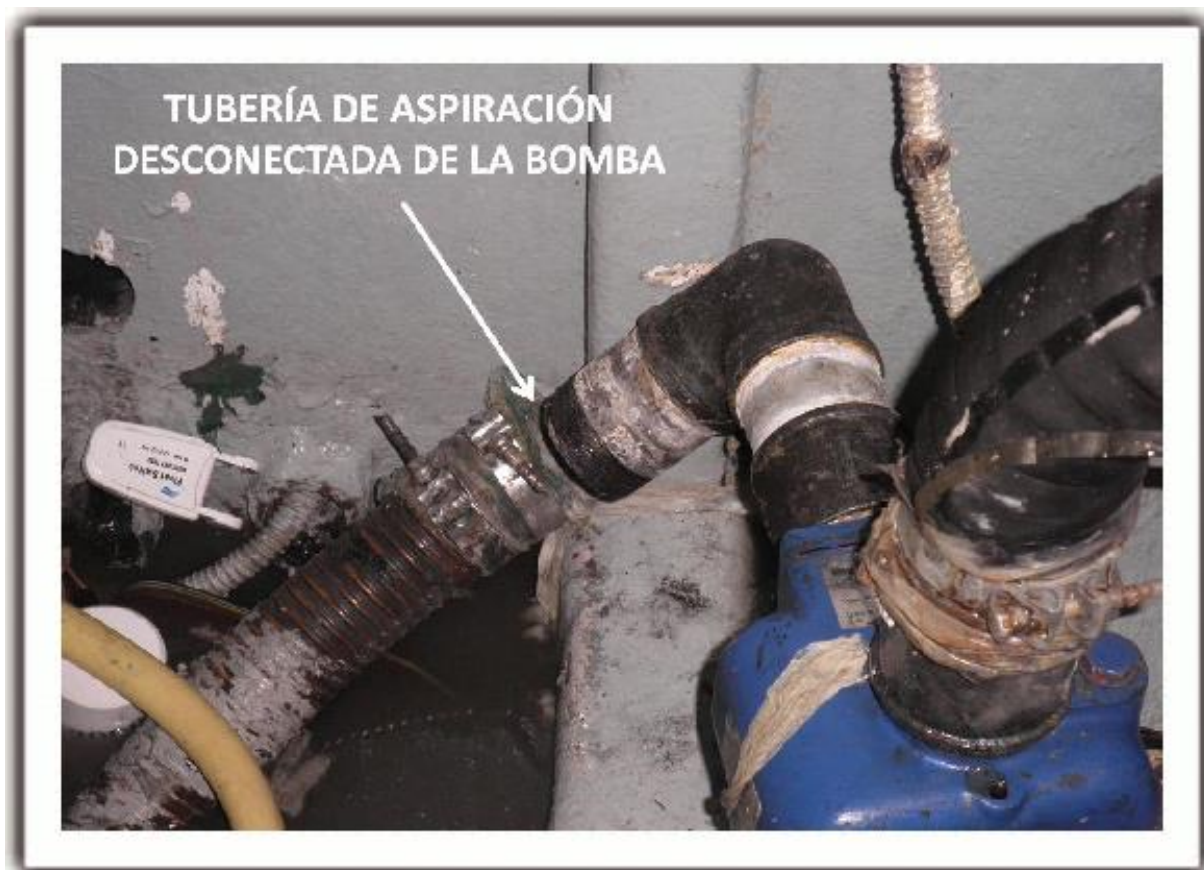
Figura 2. Tubería de aspiración desconectada de la bomba del tanque de retención
