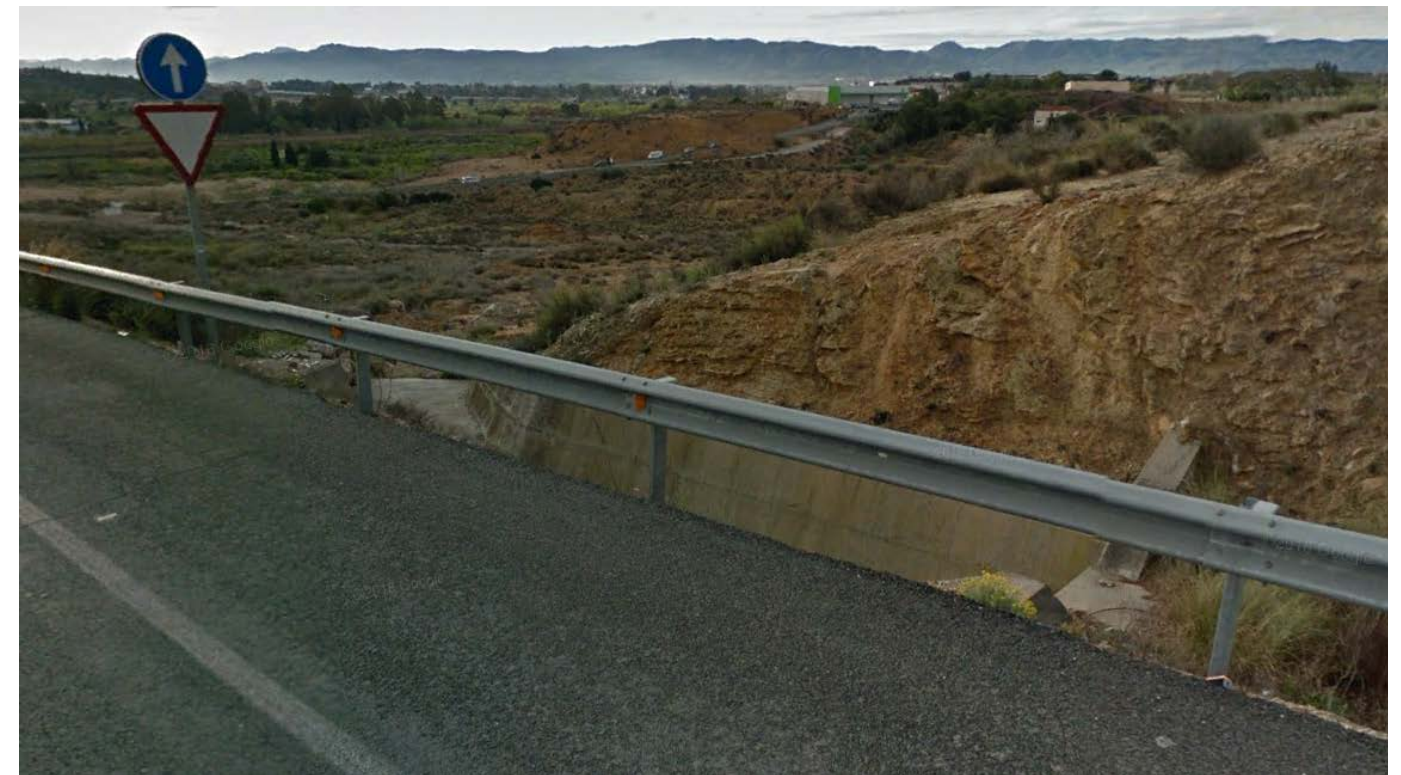
Foto 4: Canal recogida de aguas
