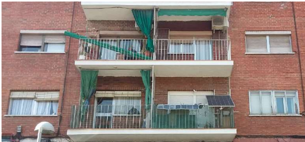
Figura 5.63. Imagen ilustrativa de la problemática de la integración arquitectónica de los equipos para el autoconsumo en viviendas plurifamiliares existentes.
