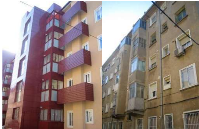
Figura 5.59. Rehabilitación de edificio con instalación de ascensor por el exterior (con derribo de escalera) y reorganización del espacio del tendedero. Grupo Francisco Franco.
