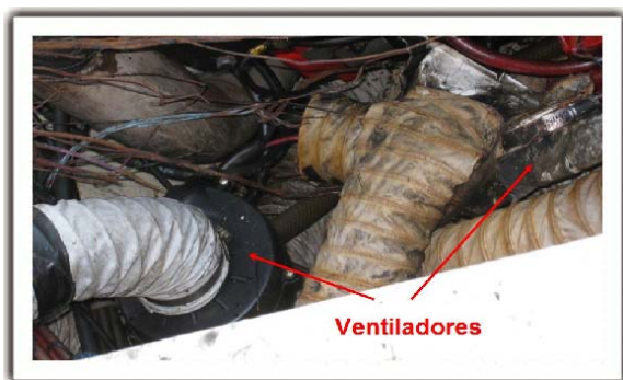
Figura 9. Ventiladores del sistema de aireación
