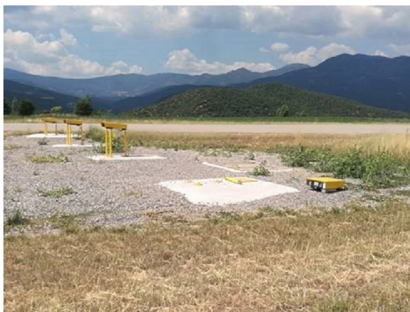
Figura 2. Daños en luz de PAPI
