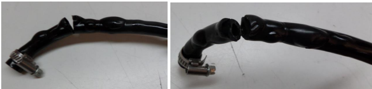
Fig. 5: Mangueras de combustible en mal estado
