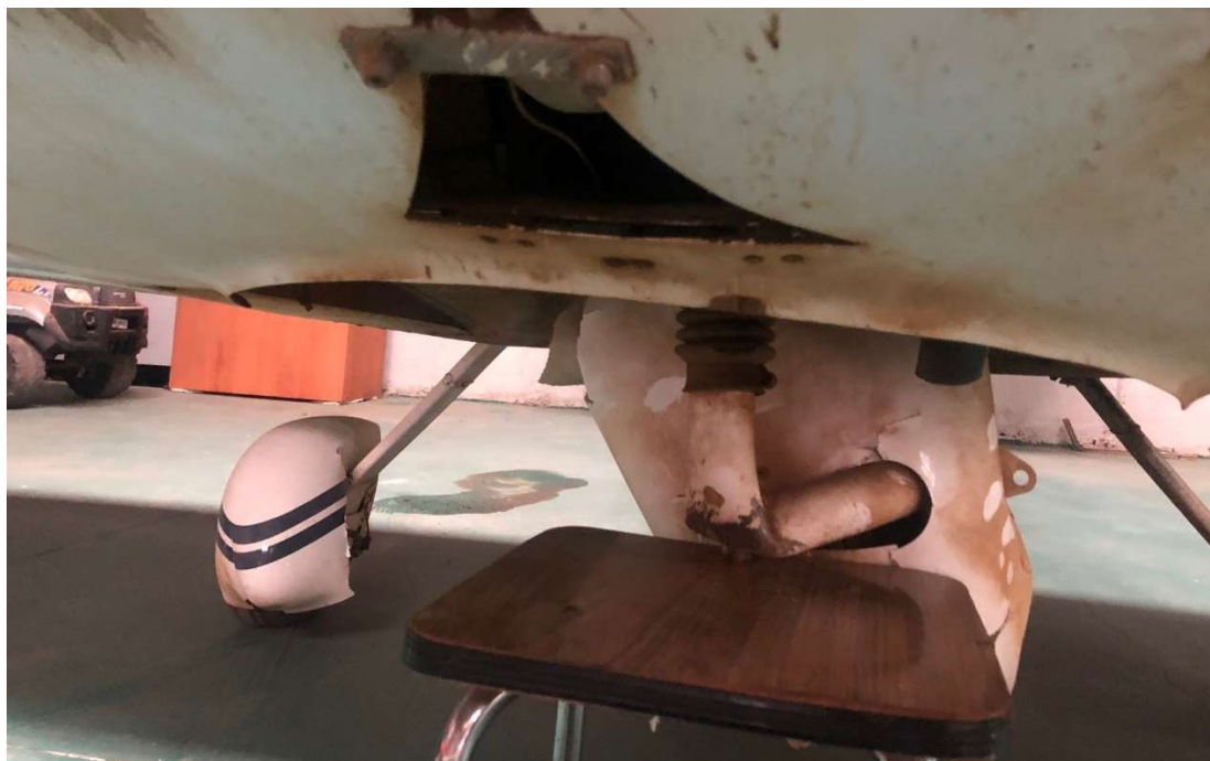
Figura 5 – Daños en pata de tren de morro y en carena de la pata derecha del tren principal.
