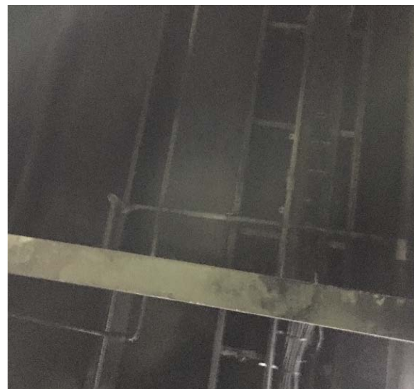
Figura 8. Daños no estructurales en el techo del garaje de la cubierta nº3
