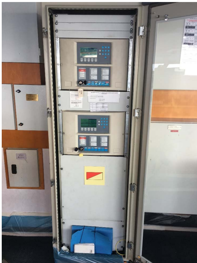
Figura 4. Central contraincendios instalada en el puente del buque MARTIN I SOLER
