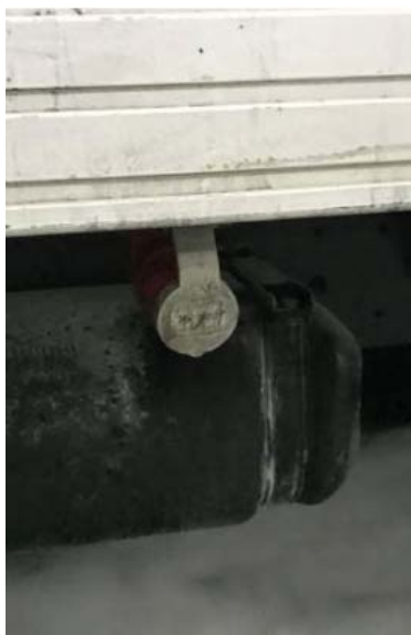
Figura 11. Conexión eléctrica del camión
