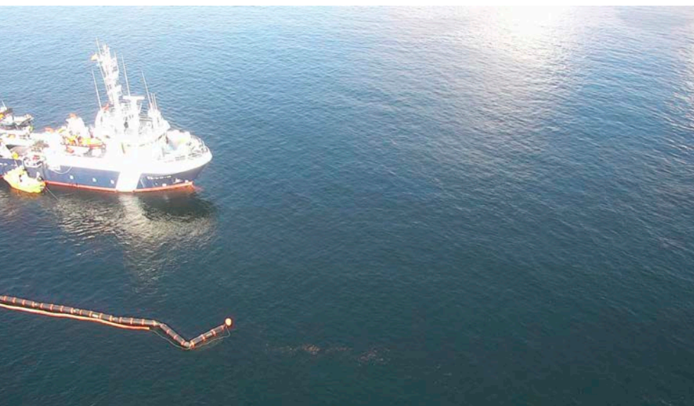
Barreras instaladas para mitigar un vertido, procedente de tierra, en la ría de Arousa, en el mes de febrero de 2020
