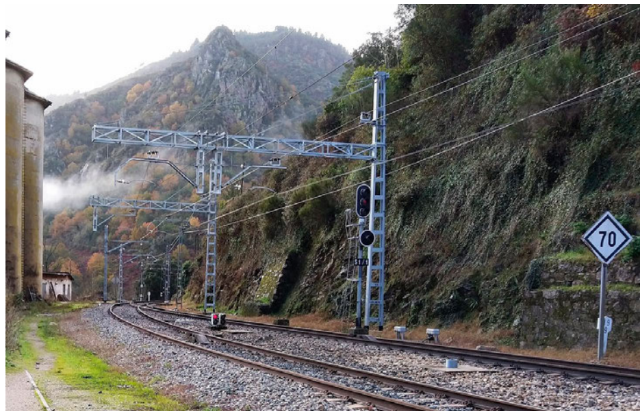
Instalaciones Seguridad (Ourense-Monforte).
