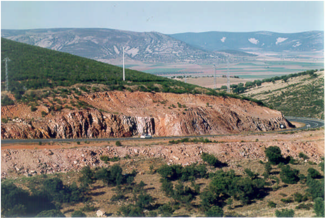
Foto 30. Talud de excavación en los materiales alternantes cuarcíticos del grupo litológico (121a). En él se observan problemas de corrimiento de cuñas, y como ha sido retirada la montera coluvial para evitar problemas de deslizamiento.
