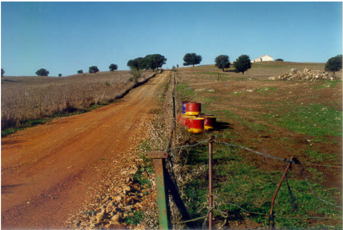
Foto 55. Deslizamiento en profundidad de los materiales alterados del grupo litológico (010a). En el segundo plano se observa como la carretera ondula a consecuencia de los movimientos de la ladera. Camino al castillo de Hojalora desde la Casa de las Terceras.
