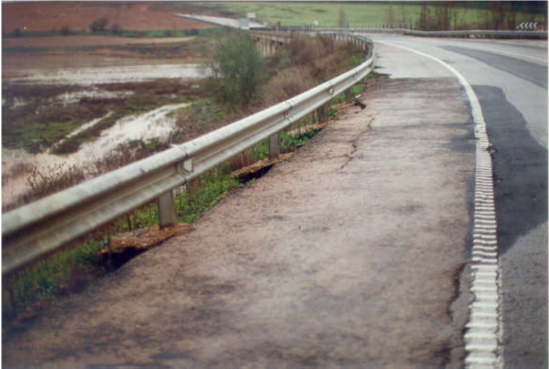
Foto 35. Vista del puente de la CN-430 sobre el río Guadiana en la Zona de Alarcos durante la crecida del invierno de 1996-97. Se puede apreciar los desperfectos del firme como consecuencia de las deformaciones sufridas por el terraplen que se apoya sobre los depósitos pantanosos de la terraza de inundación.
