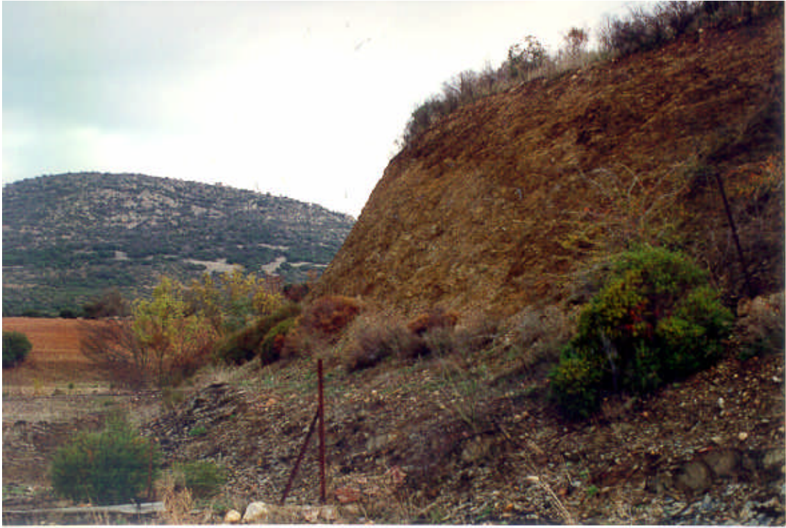
Foto 52. Talud excavado sobre los materiales pizarrosos del grupo litológico (122a). Pk(264) de la carretera nacional 430.
