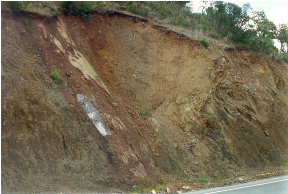
Foto 53. Corrimiento de una cuña en pizarras deslizadas del grupo 122a en zona de contacto por falla con el grupo 122b. Pk.(243) de la carretera nacional 430.
