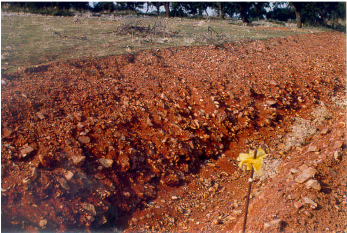
Foto 18. Conglomerado brechoide rico en finos constitutivos de los coluviales típicos de las zonas de piedemonte de los relieves cuarcíticos. En esta pequeña zanja en la cuneta de la carretera de Abenojar se puede observar la poca estabilidad de los taludes excavados en este tipo de material.
