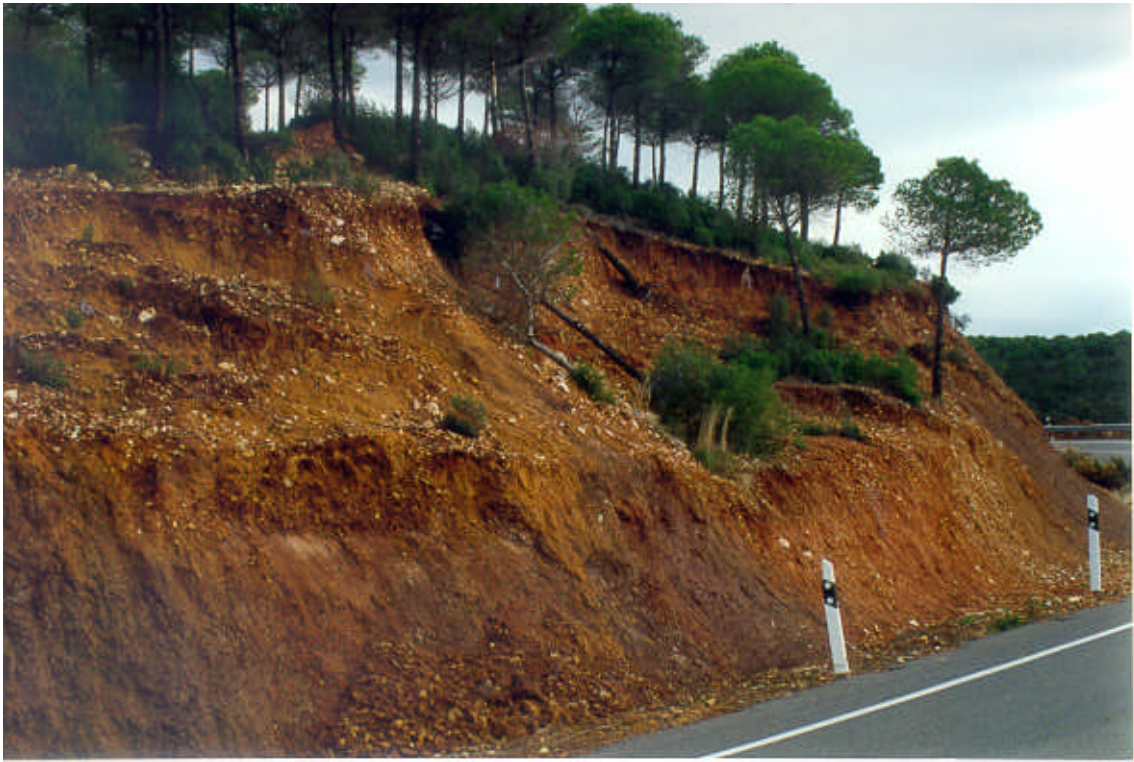
Foto 45. Talud artificial inestable excavado en un sector de ladera con deslizamientos fósiles que implican a pizarras del grupo 122a y a depósitos de raña 350, carretera nacional 430, pk. (254).
