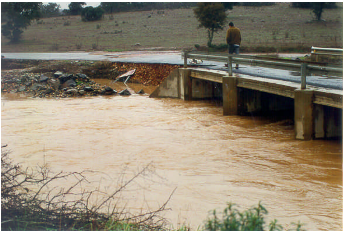
Foto 37. Desplome en el terraplén del trasdós del estribo del puente sobre el arroyo de la Puente, cercanías de Saceruela.
