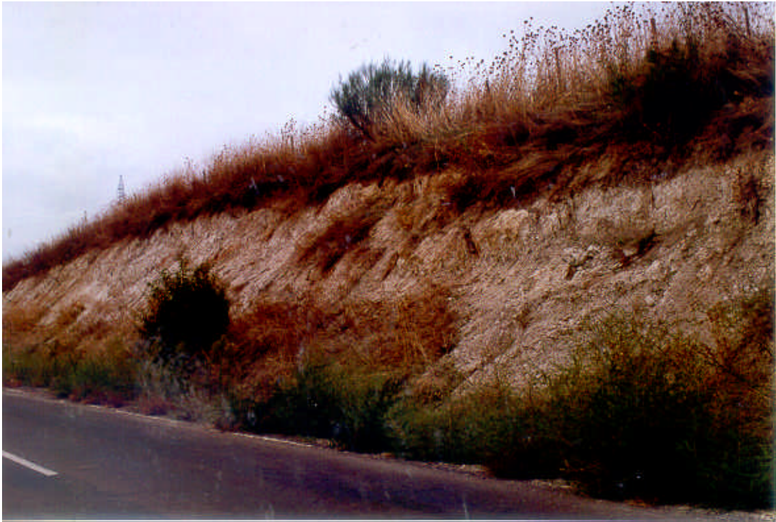
Foto 7. Materiales margosos con arcillas expansivas pertenecientes al grupo litológico (322a). Obsérvese el mal estado de los taludes. Proximidades del puente de Alarcos.
