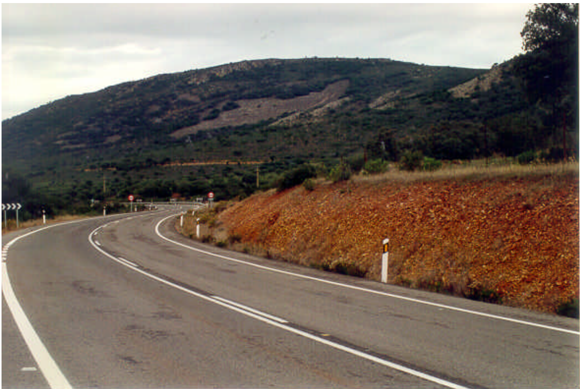
Foto 19. Foto tomada desde el p.k.(258) de la CN-430. En primer término un pequeño talud de excavación en materiales de la raña grupo 350. Al fondo una ladera cubierta por derrubios de gravedad con una amplia zona de canchales, en la que pueden apreciarse rasgos de inestabilidad fósil. Coluvial y raña constituyen un manto de recubrimiento sobre los materiales del paleozoico sin solución de continuidad.
