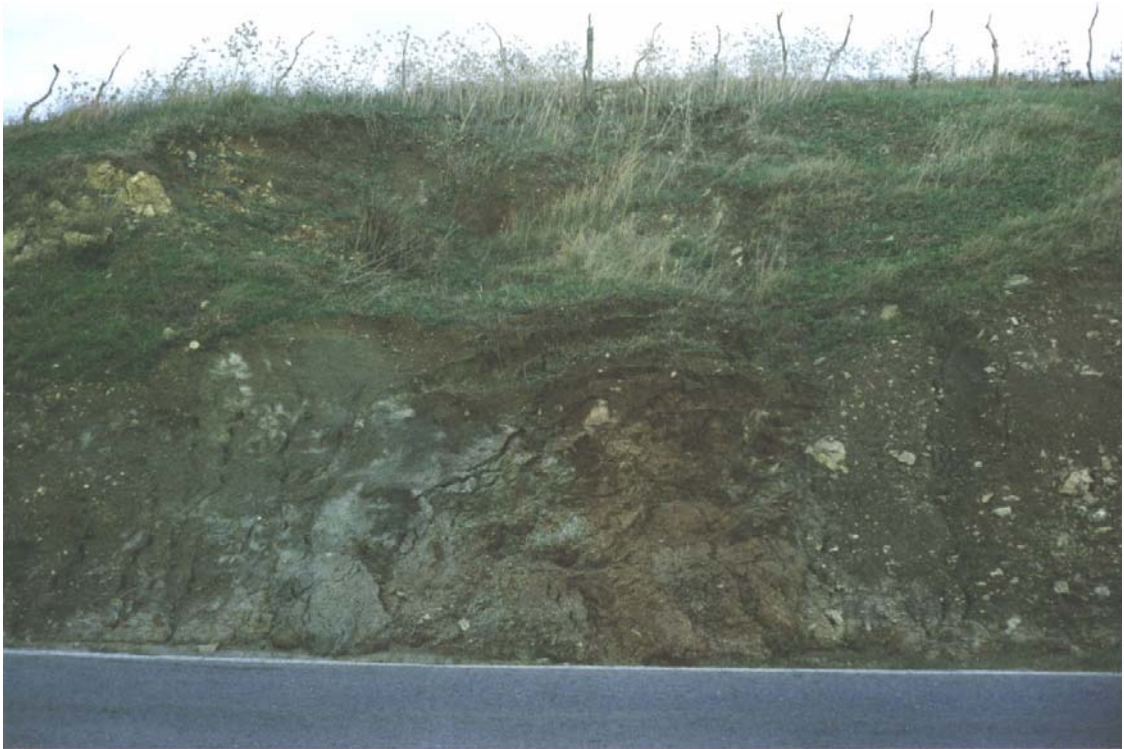
Figura 3.78. Talud de pequeña altura realizado en los materiales arcillo-margosos del grupo (313e), que muestra problemas de estabilidad rotacional. Proximidades del p.k. 98 de la carretera C-440 (Hoja 1075-3).
