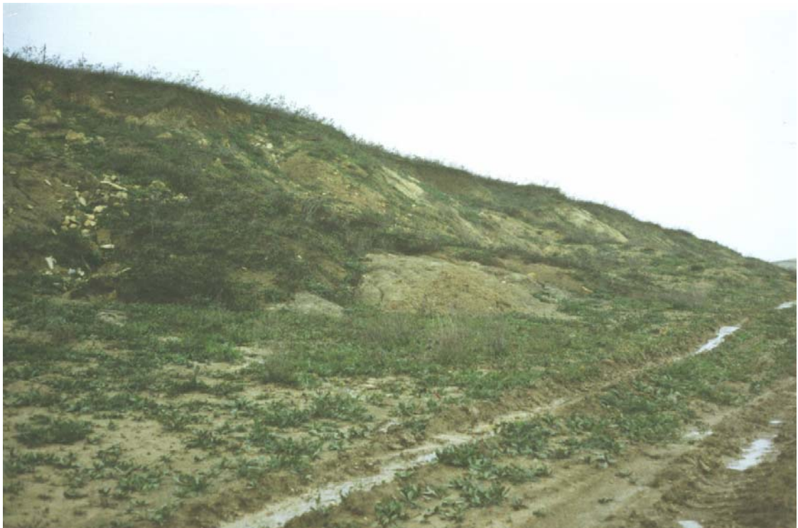
Figura 3.46. Deslizamientos sucesivos en un talud de pequeña altura realizado en las arcillas del grupo (230). Proximidades del p.k. 19,5 de la carretera C-440 (Hoja 1062-2).
