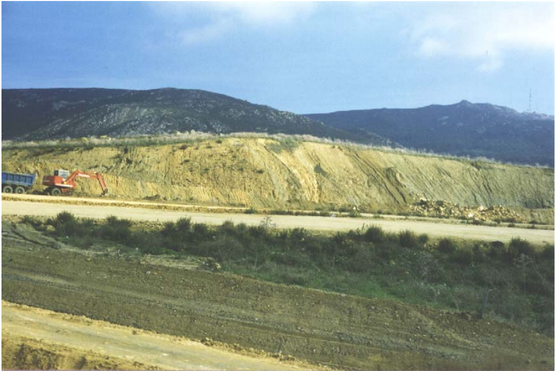
Figura 3.79. Talud de altura media realizándose en las obras de la autovía N-340, en las proximidades de la localidad de San Roque (Hoja 1075-3). Puede observarse el aspecto de la disposición de los materiales.
