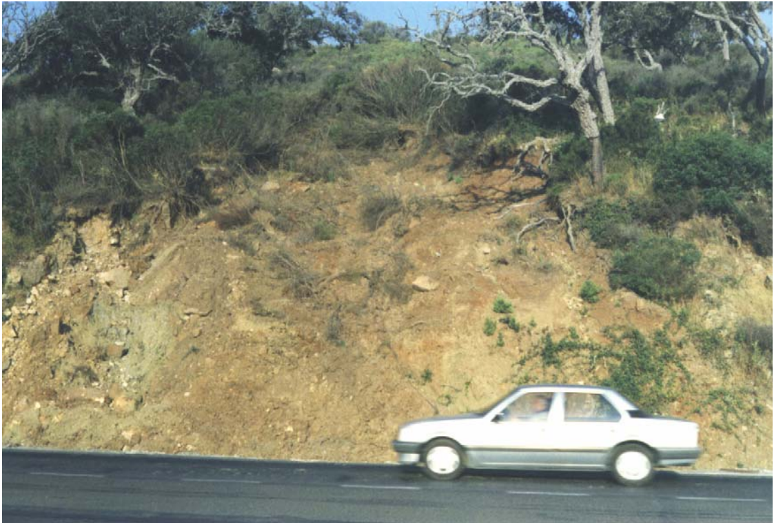
Figura 3.70. Talud de pequeña altura y una inclinación de 40°, realizado en los materiales arcillosos del grupo (321b), afectado por un deslizamiento superficial. Carretera C-440 (Hoja 1074-1).
