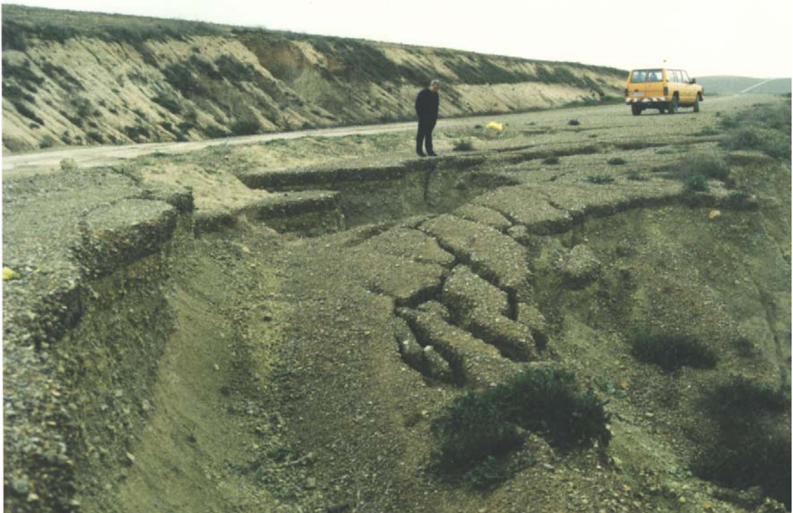
Figura 3.45. Deslizamiento producido en una ladera formada por los materiales arcillosos del grupo (230), en la que se apoya el firme de una variante a la carretera C-440 (abandonada), que también ha sido afectado (Hoja 1062-2).
