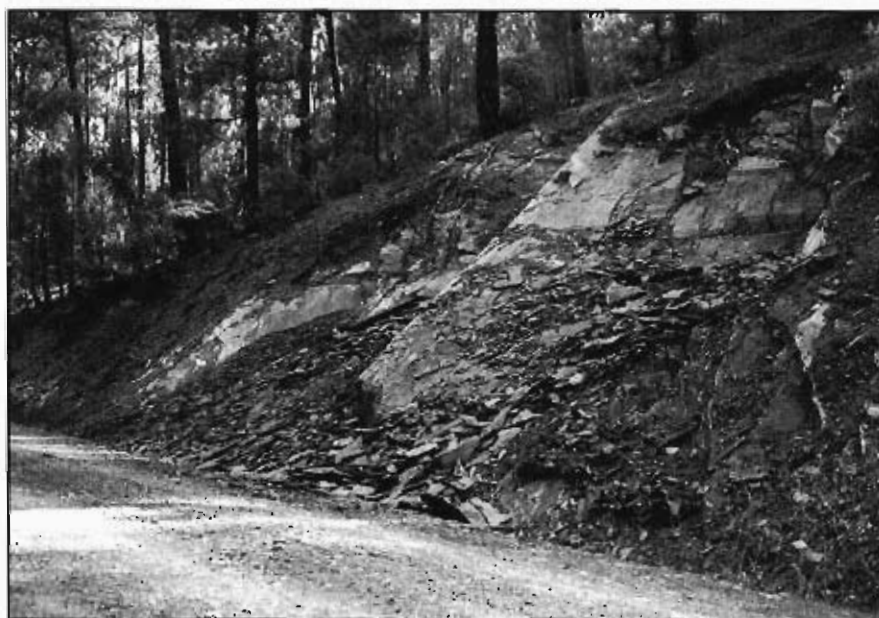
Figura 3.87.- Talud de baja altura y de 35° de inclinación, en el que han deslizado dos cuñas formadas por la esquistosidad y una familia de diaclasas. Pista forestal del río Cabriel, en las proximidades del p.k. 1 de la carretera local a Boniches (Hoja 636-1).
