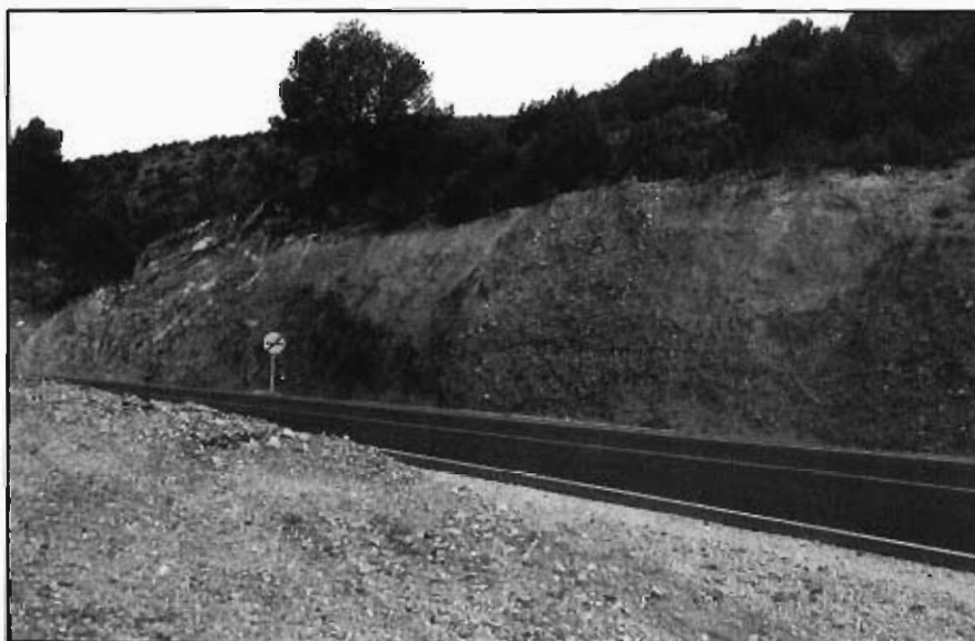
Figura 3.23.- Talud de baja altura realizado en materiales del grupo (321a), en la carretera de Cardenete a Villora (Hoja 664-1). Puede observarse (al fondo) la discordancia formada con rocas jurásicas, así como la disposición y naturaleza de los materiales.
