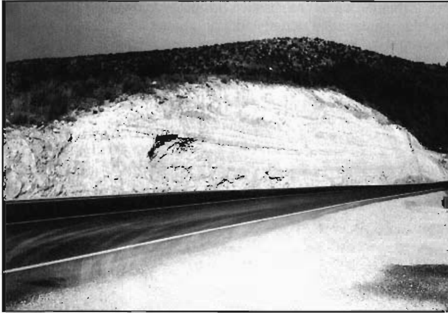
Figura 3.17.- Talud de altura media, realizado en la carretera local que une las carreteras de Cardenete y Villora (Hoja 664-1 y 2). Puede observarse la estructura de los materiales y algunos "desconchones" en la superficie del talud.
