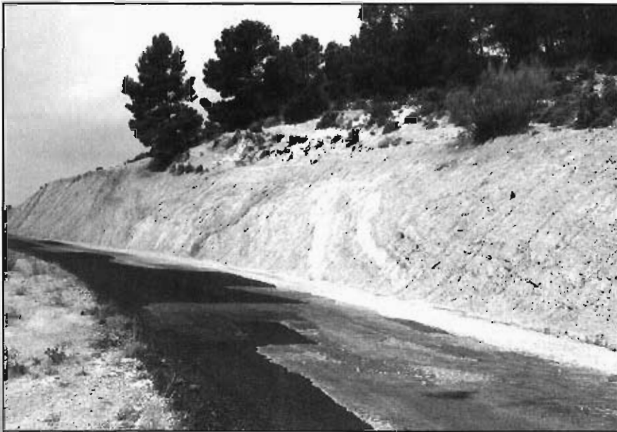
Figura 3.64.- Talud de baja altura realizado en la serie areniscosa del grupo (213). Puede observarse la estructura de plegamiento apretado que muestran los materiales, así como el estado de la calzada a lo largo de todo el desmonte. Carretera local de Vállora a Mira, p.k. 27 (Hoja 664-2).
