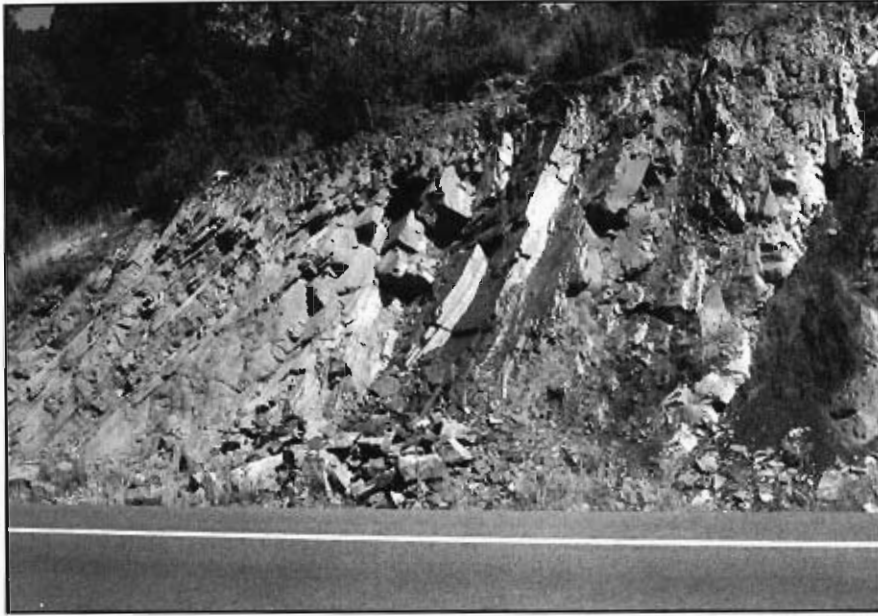
Figura 3.72.- Cuñas y bloques producidos en las areniscas del grupo (211b) como consecuencia de la intersección de los planos de fracturación y de estratificación. Se observan las acumulaciones de los bloques deslizados o caídos, en el pie del talud.
