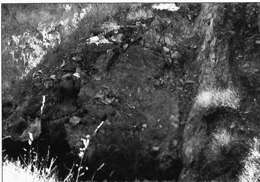
Fig. 4.3.- Pequeño deslizamiento producido en un talud ejecutado en un horizonte de alteración de metatobas.
