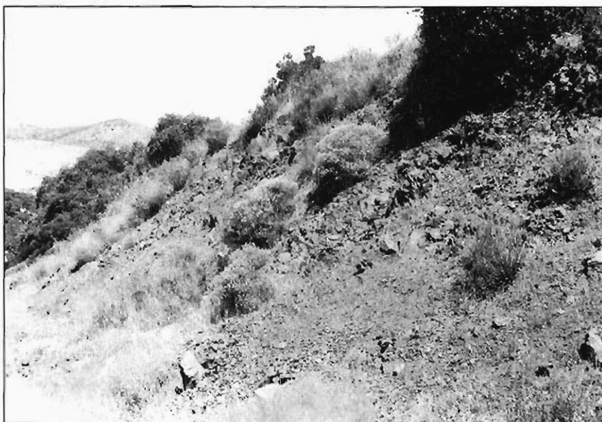
Fig. 4.2.- Talud excavado en roca muy fracturada, que presenta una caída permanente de cantos.
