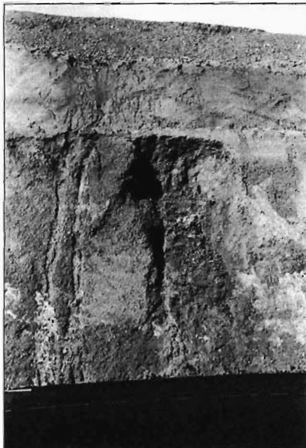
Fig. 4.3.— Pequeño deslizamiento producido en un talud del grupo 321a en la carretera N-120, en las inmediaciones de Ledigos.
