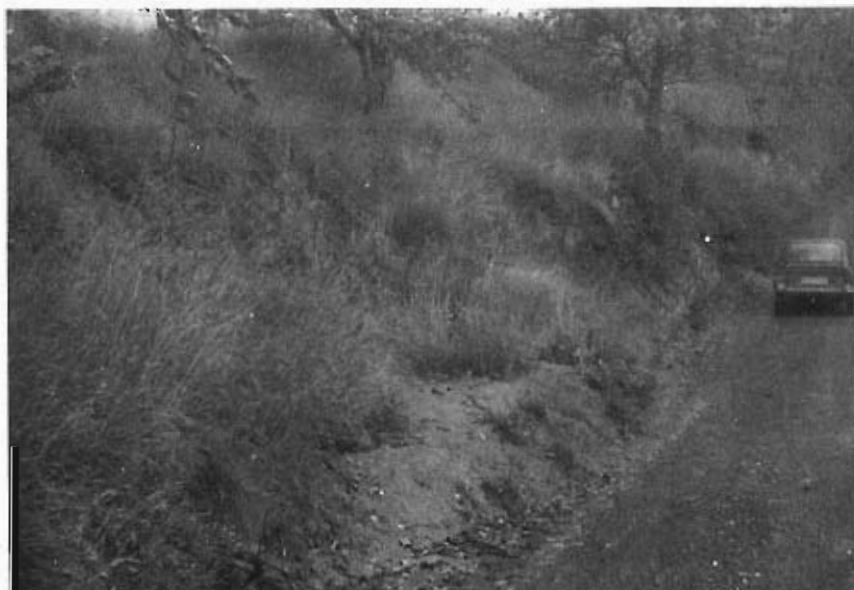
Foto 3.— Movimientos en los taludes del grupo C3.
