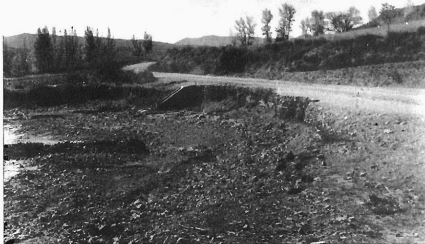
Foto núm. 25. A2. Obsérvese la gran cantidad de aportes y la socavabilidad lateral.
