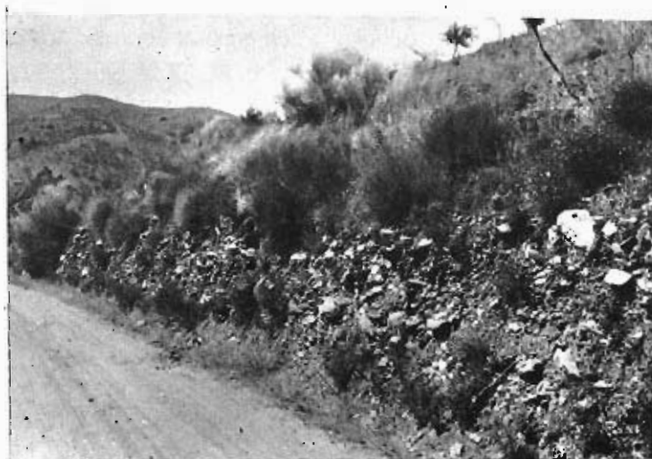
Fig. 39. Aspecto general del talud desarrollado en los conglomerados del grupo 322, en las proximidades de Timar.
