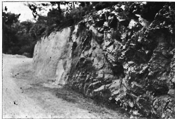
Fig. 34. Contacto fallado entre los grupos 213b y 213c. Obsérvense la trituration de unas y el aspecto más homogéneo de las otras.
