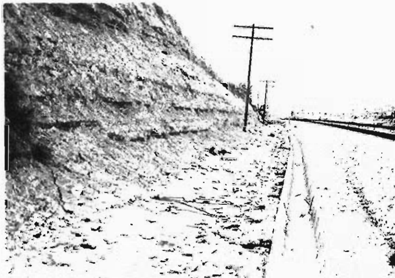
Foto 19.— Talud artificial en la "Formación Yesífera de Alcubierre" sobre F.C. Zaragoza—Barcelona.
