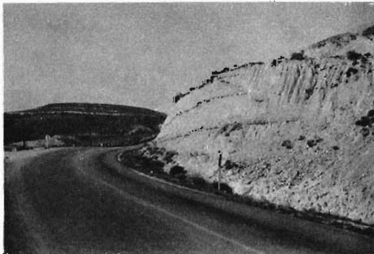
Foto 16.— Formación margosa de Alcubierre. Aspecto del talud en la carretera N—123 de Zaragoza a Huesca km 64.
