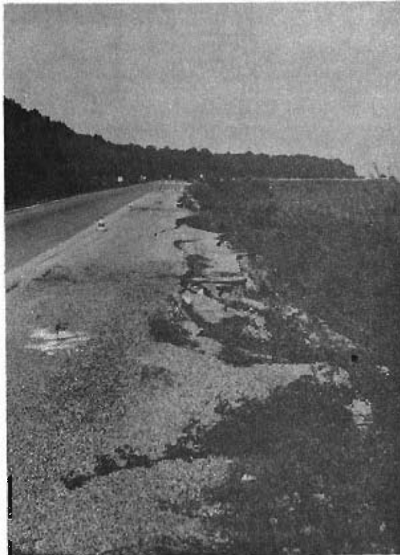
Foto 17.— Deslizamiento en la carretera N-123 de Zaragoza a Huesca sobre la formación margosa de Alcubierre (321 d).
