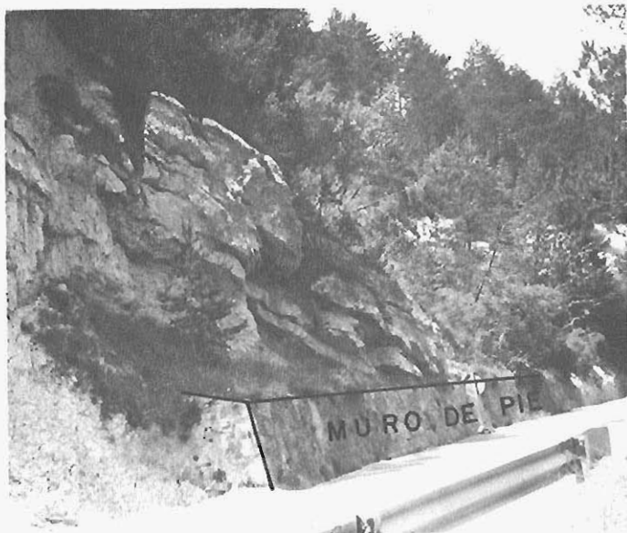
Foto 3.18.— Colapsos en los yesos del grupo 312p.
