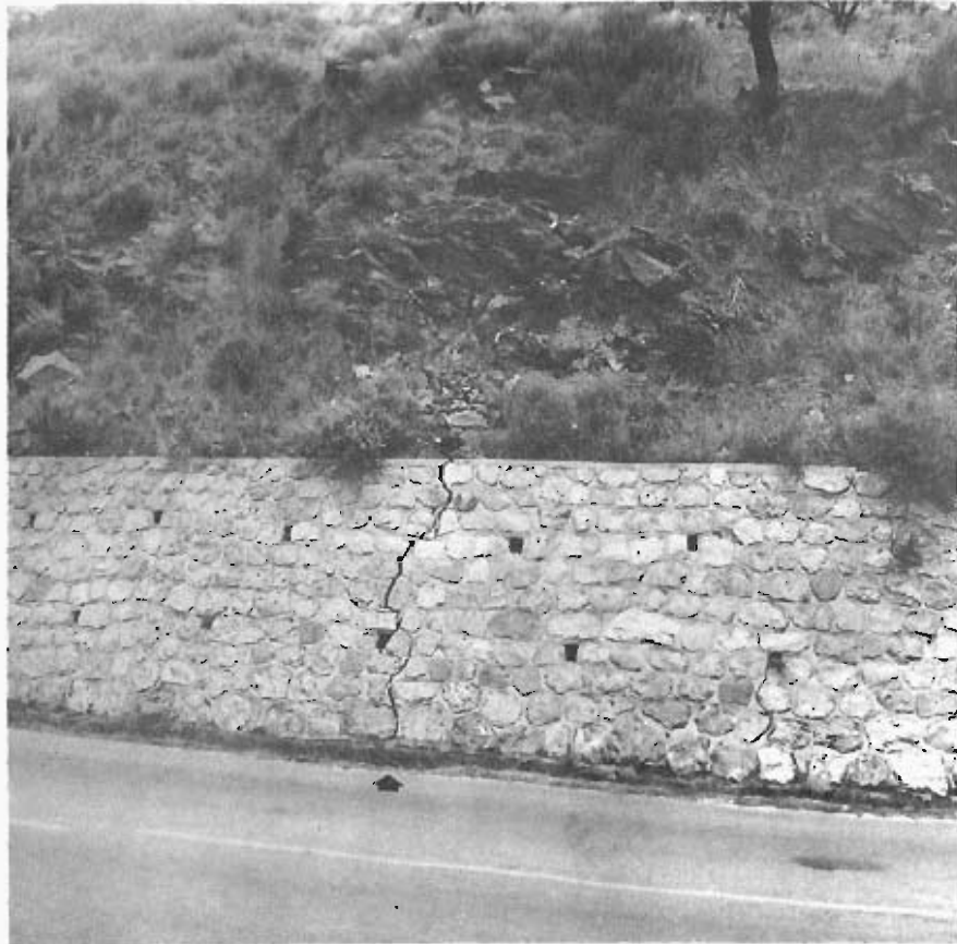
Foto 40.— Muro agrietado en micaesquistos de Salobreña (100p'). (Carretera N—340 junto a Salobreña).
