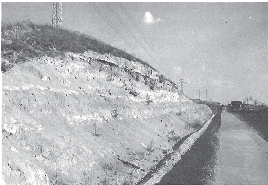
Foto 21.— Corte en el Km 22 de la carretera nacional IV. Margas blancas sobre arcillas verdes. C-582-3
