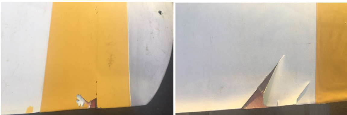
Figura 2. Daños en extradós
