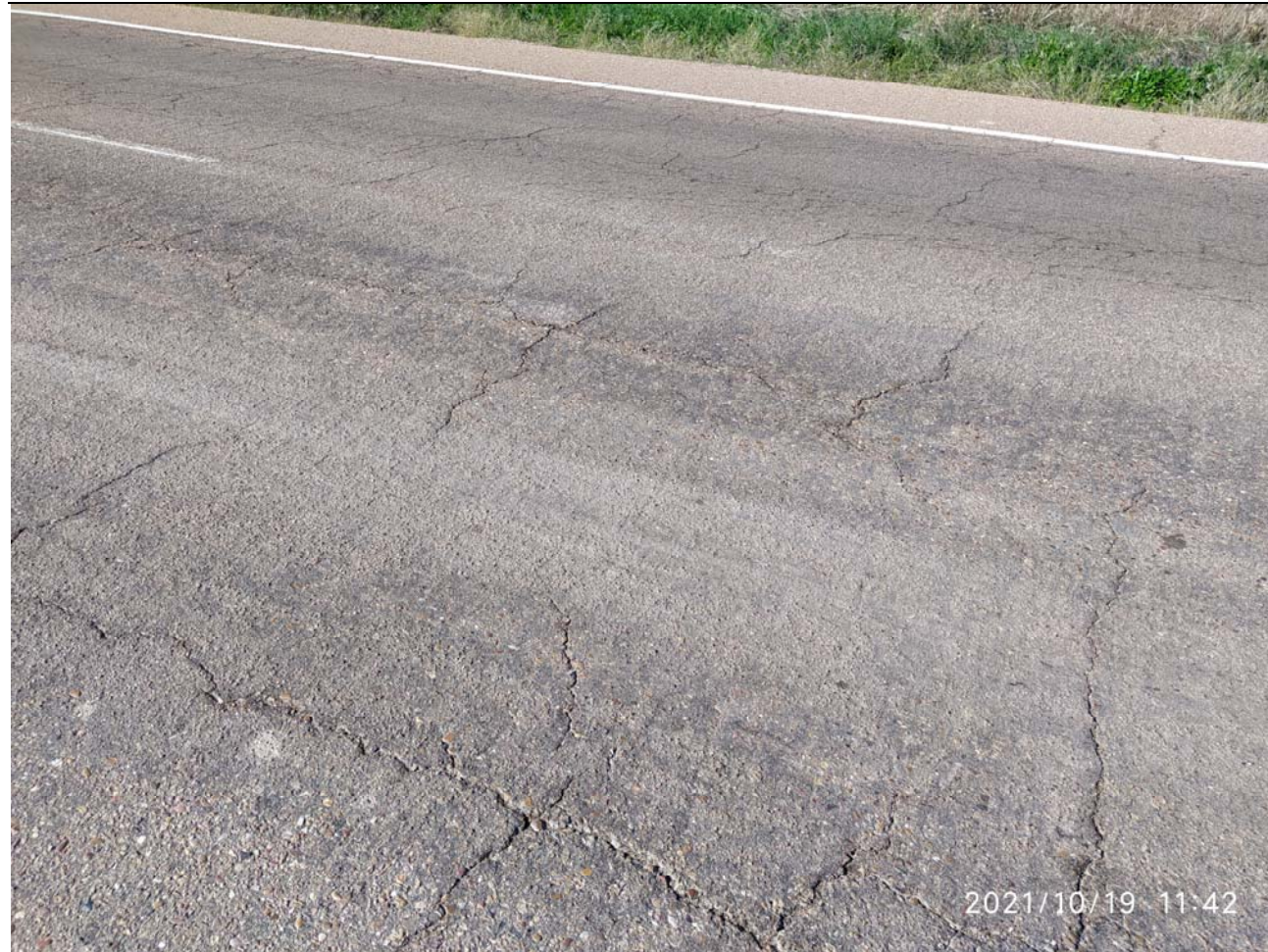
Detalle del estado de fisuración del firme
