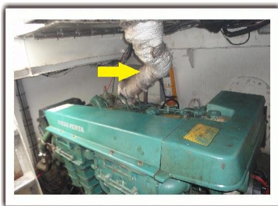
Figura 5. Detalle de la cámara de máquinas. Vista hacia popa-babor.
