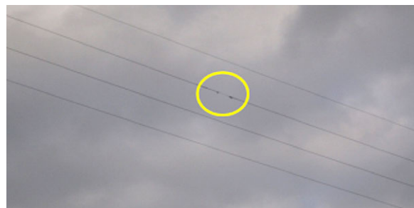
Figura 3. Daños en un conductor de la línea
