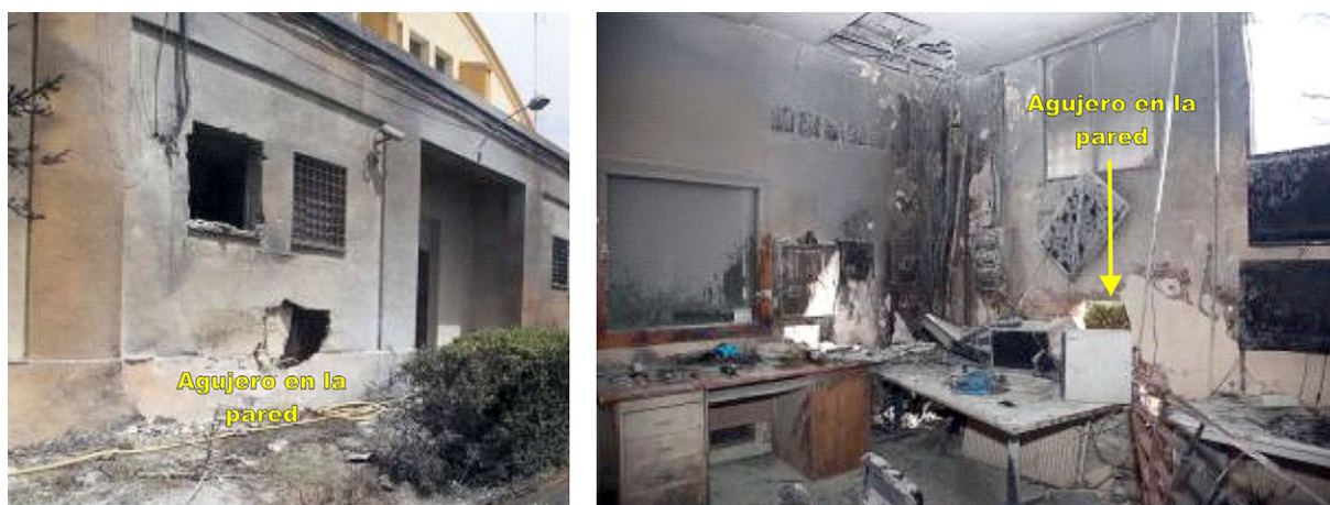
Figura 5. Daños en hangar del CNP
