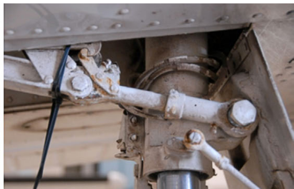
Estado del sistema de tren izquierdo en posición de bloqueo con brida
