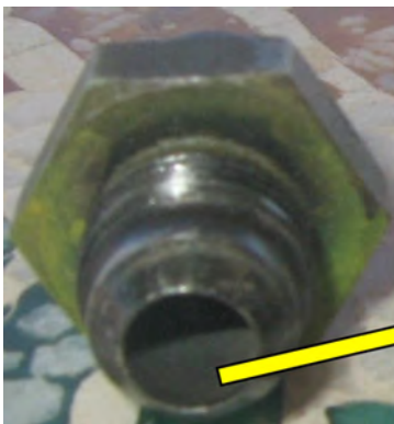
Figura 2. Conector parcialmente obstruido
