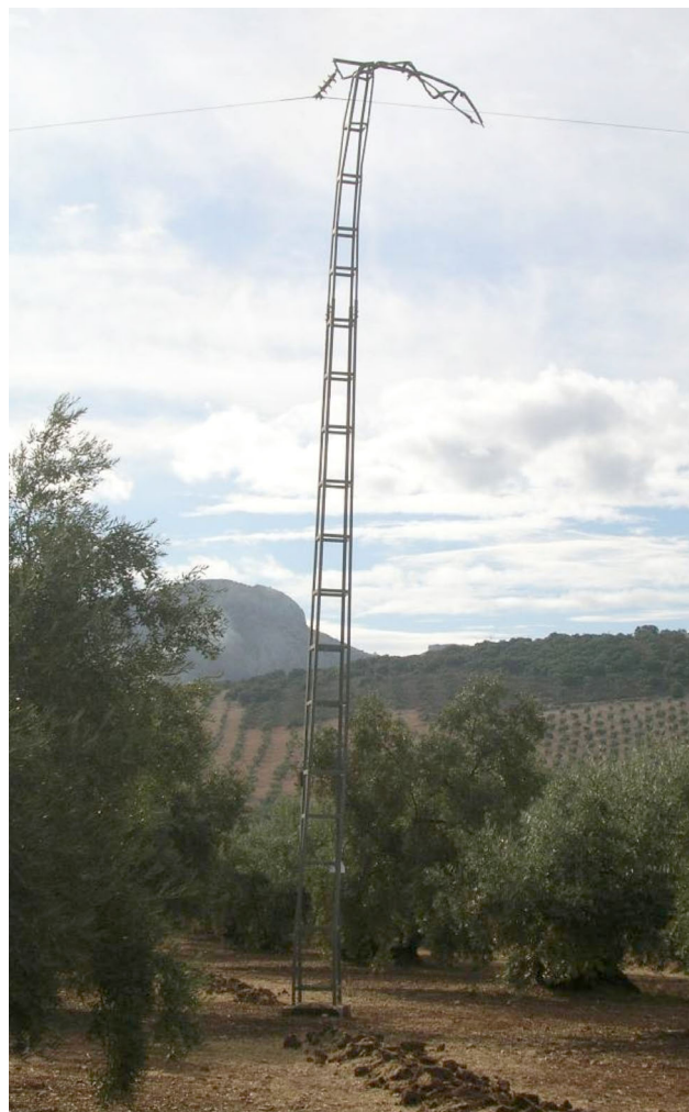
Figura 3. Poste del tendido eléctrico dañado
