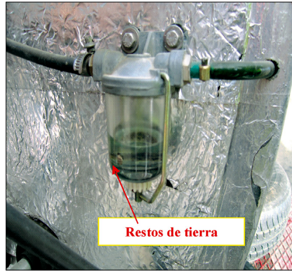
Figura 2. Estado del gascolator
