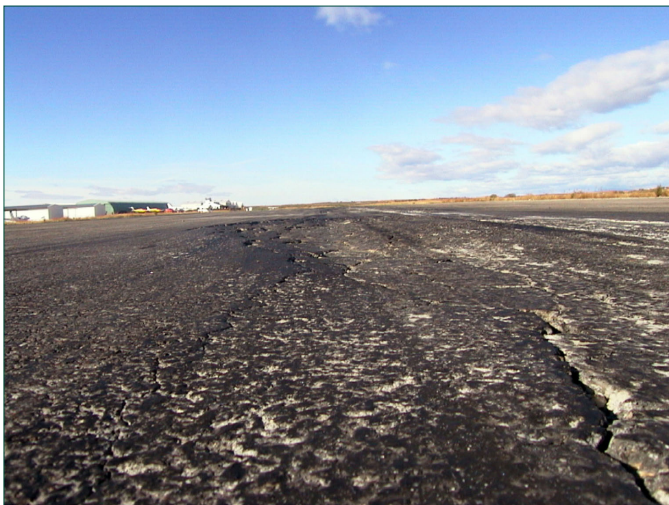
Foto 1. Estado del pavimento de la pista
