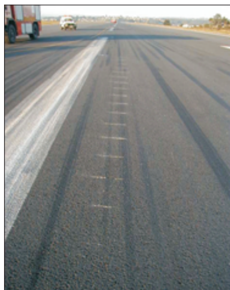
Foto 2. Marcas de la hélice en la pista
