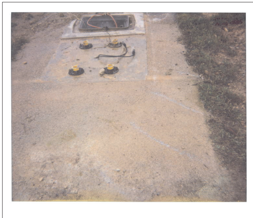
Foto A-6. Detalle del paso de la aeronave sobre el basamento de hormigón de las luces del PAPI. Obsérvense los trazos transversales producidos por las puntas de las palas de la hélice izquierda
