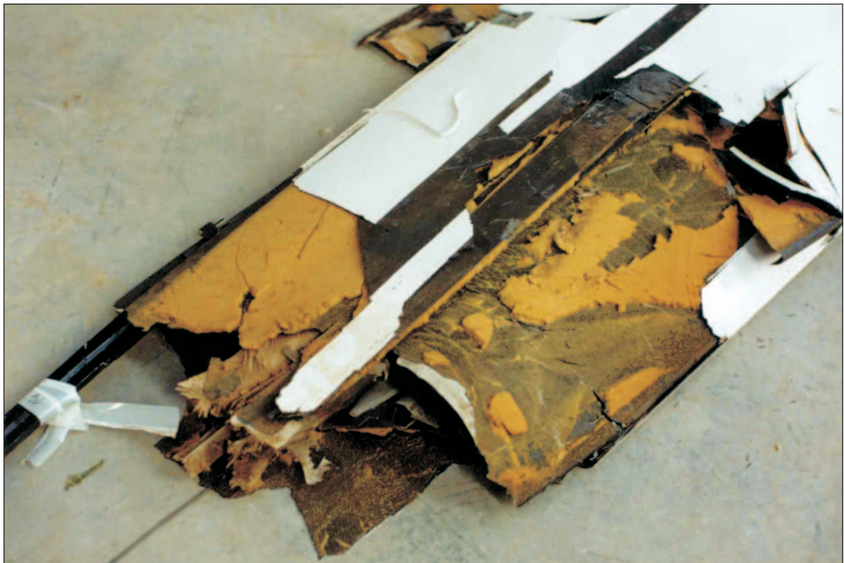
Rotura exterior del ala derecha. Extradós
